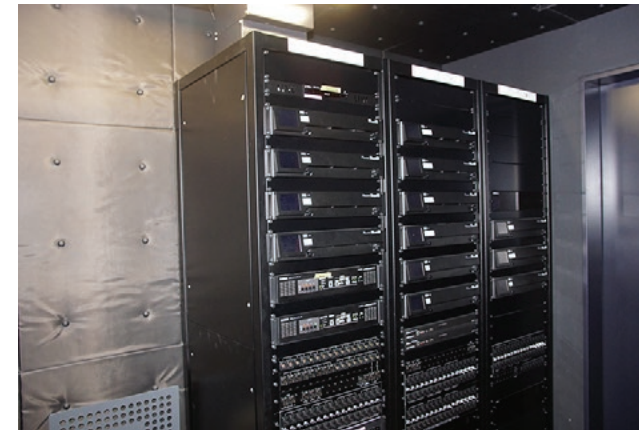
ピンスポット室のパワーアンプ架
