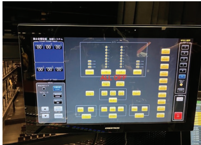
音響調整室のタッチパネル
