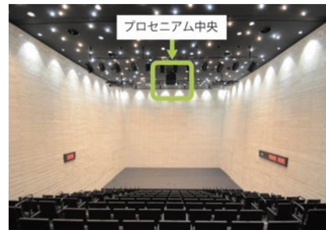
写真3 小ホールのメインスピーカー
