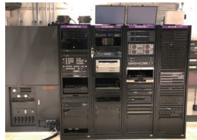
写真7 大ホール舞台下手袖の音響設備ラック
