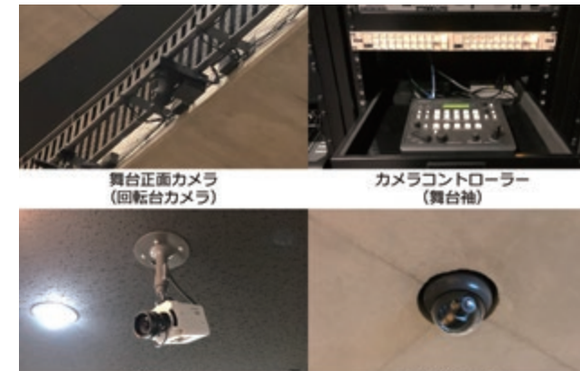
写真8 各所の ITV カメラ及びカメラコントローラー
